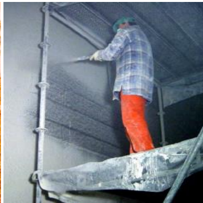
des travaux de réhabilitation onéreux
