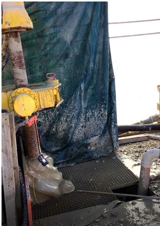
Remontée de boues, chambre de récupération
