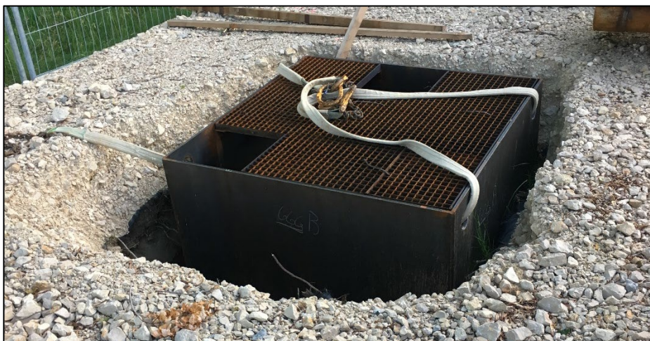
Chambre de récupération des boues
