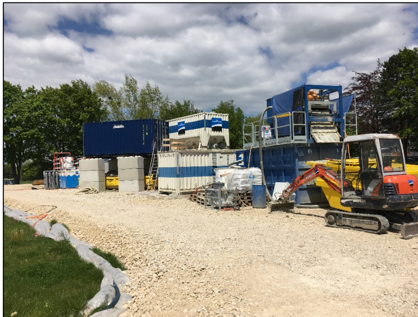
Atelier de traitement des boues
