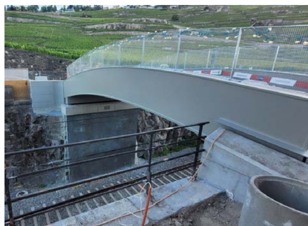
Chantier de mise au profil d'espace libre du passage supérieur de Glérolles avec culées et parapets préfabriqués
