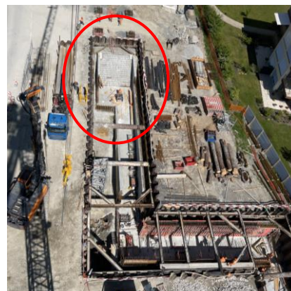
Zone touchée par l'affaissement
